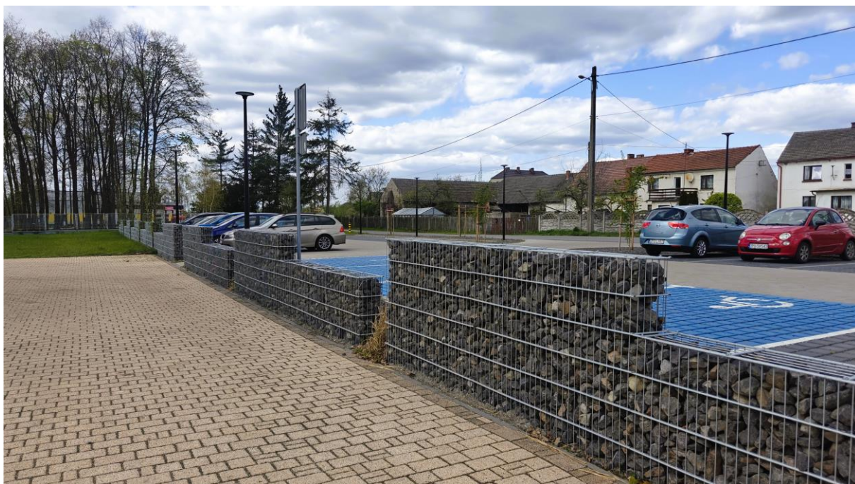
Wykonanie ogrodzenia z koszy gabionowych przy Domu Dziennego Pobytu w Chrzęstowicach (źródło: Urząd Gminy Chrzęstowice)
