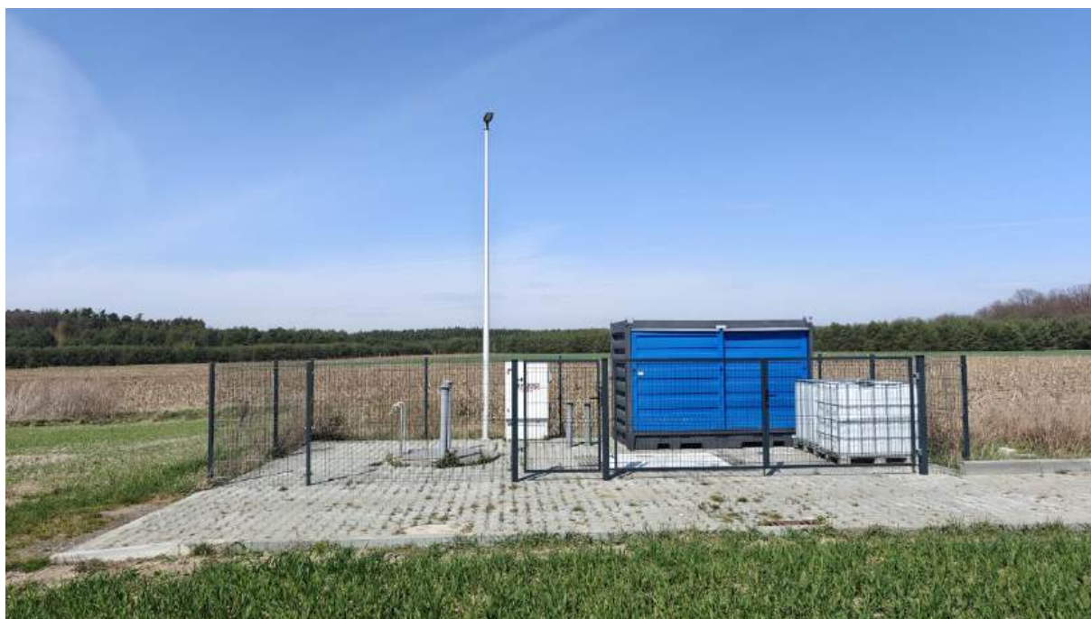
Przepompownia ścieków w miejscowości Daniec
